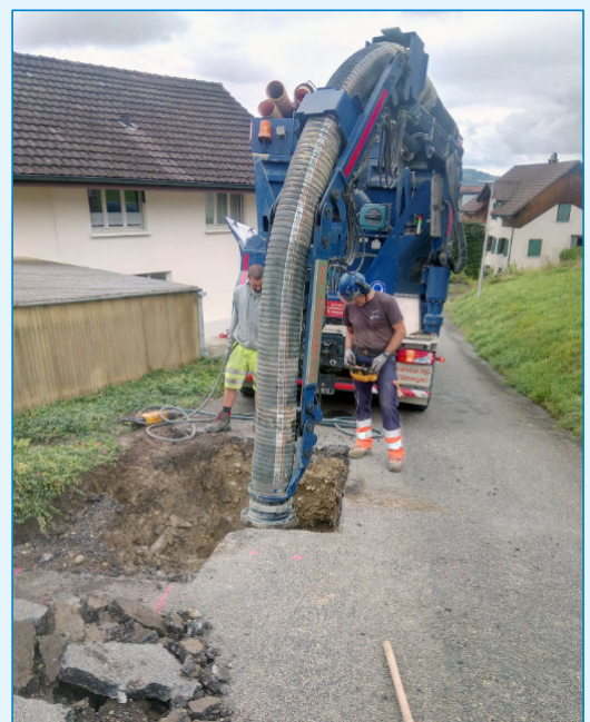
Wasserleitungsbruch im Hinterdorf, Sonntag, 25. August 2024
